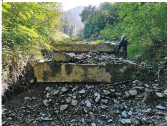
Figure 8 Zone d'incision à l'aval du seuil (radier parafouille bien affouillé)
