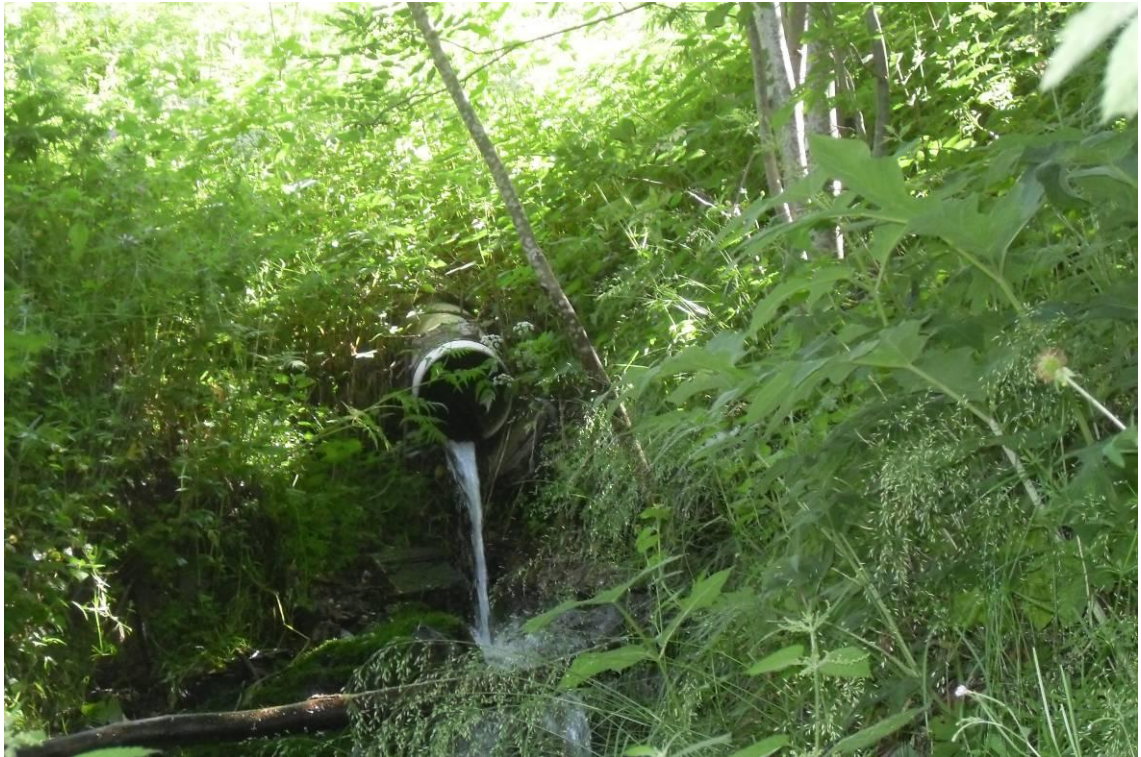
Le Village d'Ornon : rejet dans le ruisseau du Rif Garcin
