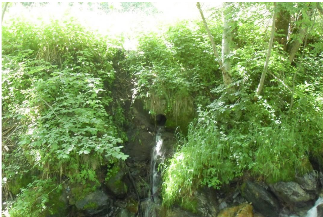
La Pouthuire : Rejet dans la Lignarre
