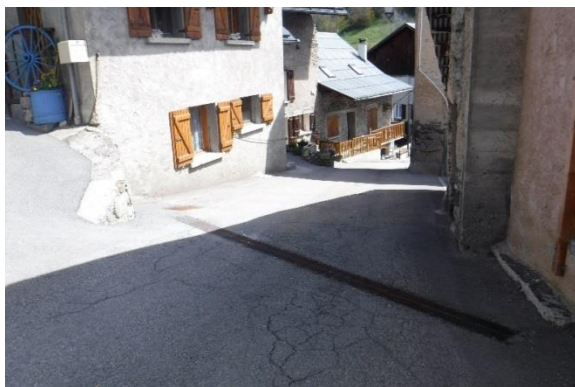
Chemin inondé (axe préférentiel de ruissellement) – Commune de Mizoën
