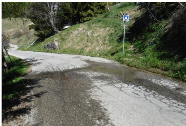
Ecoulement sur voirie – Commune d'Huez
