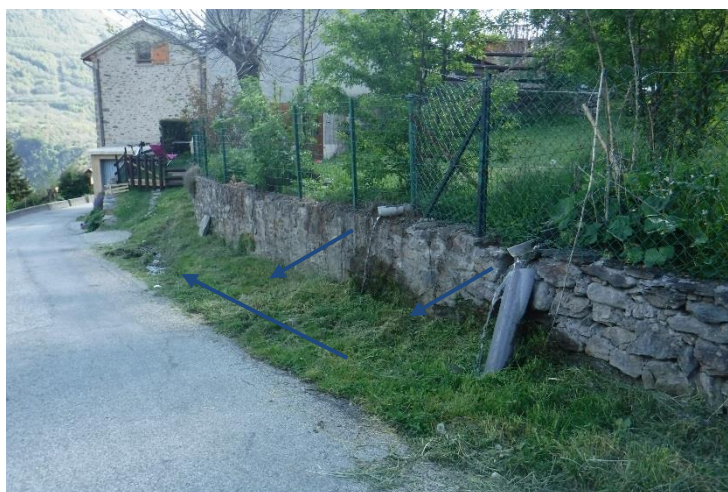
Sources raccordées au réseau mettant en charge ce dernier – Commune du Freney
