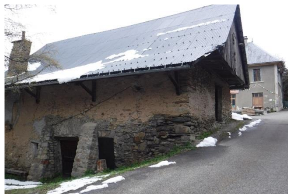
Inondation de la cave de l'habitation – Commune de Villard-Reymond
