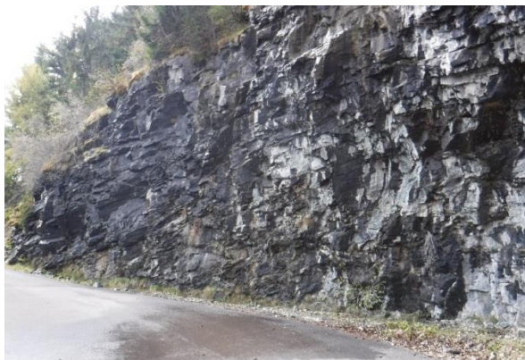
Ecoulement sur voirie depuis la falaise – Commune de Villard-Notre-Dame
