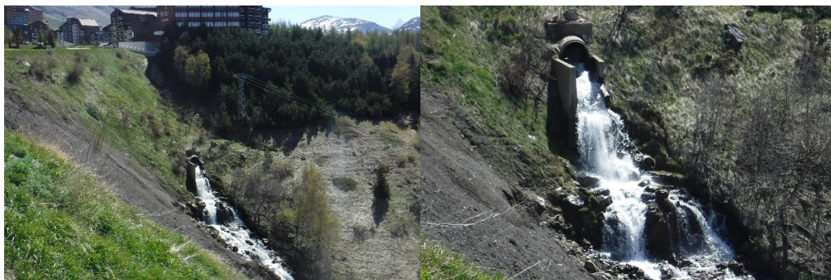
Ravinement au droit d'un exutoire à Huez
