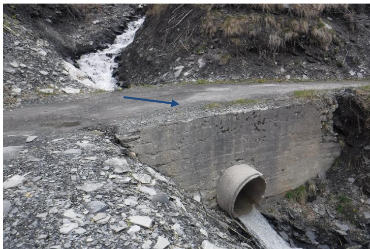
Débordement de la traversée sur voirie – Commune de Besse
